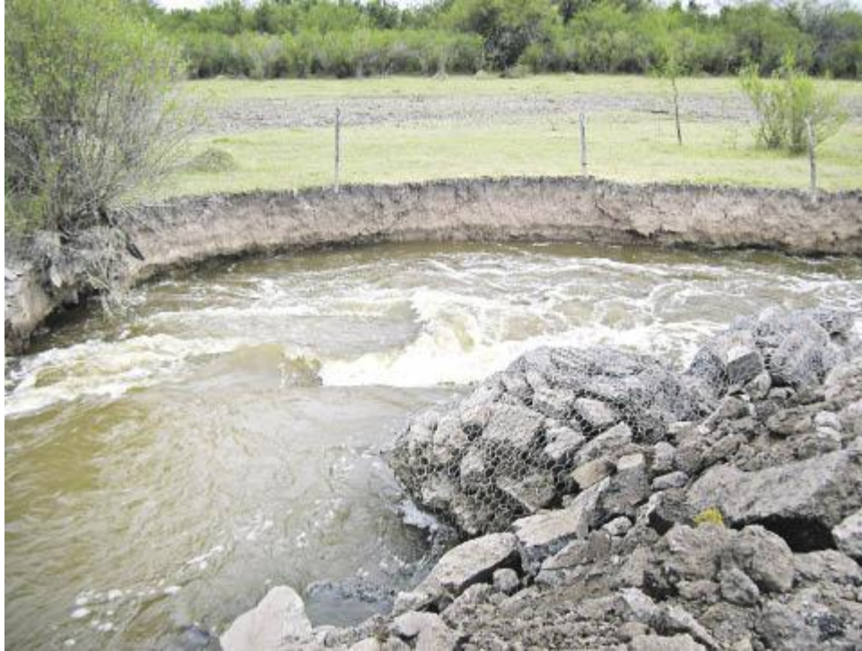
PÉRDIDA DE MARGEN POR EROSIÓN
